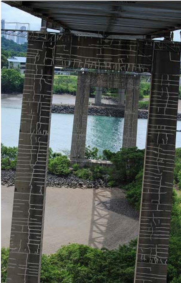
ESTADO DE PILAS ANTES DE PROYECTO
