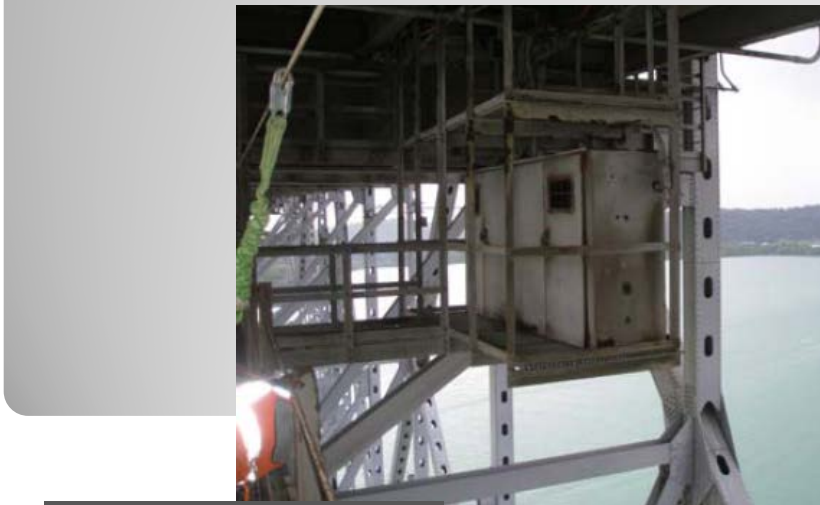
CASETA DE ELECTRICIDAD
