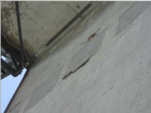
DESPRENDIMIENTO DE PARCHES
